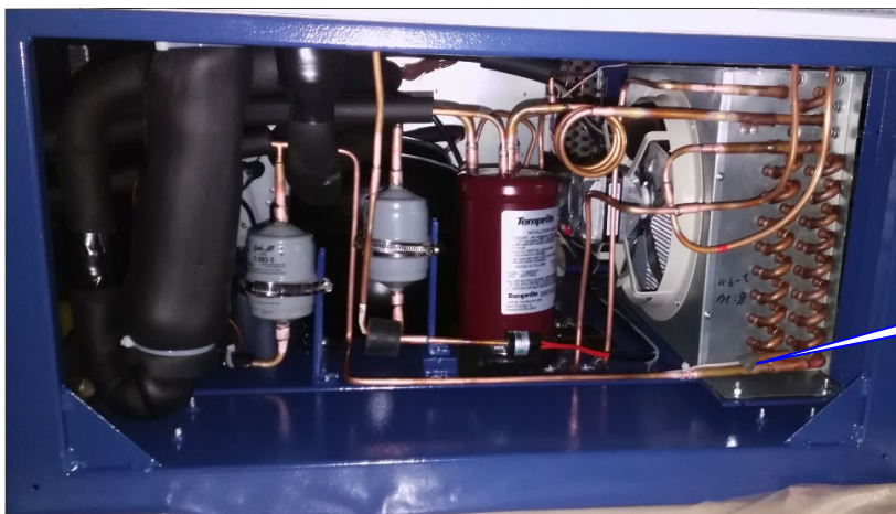
Condenser sensor E1
